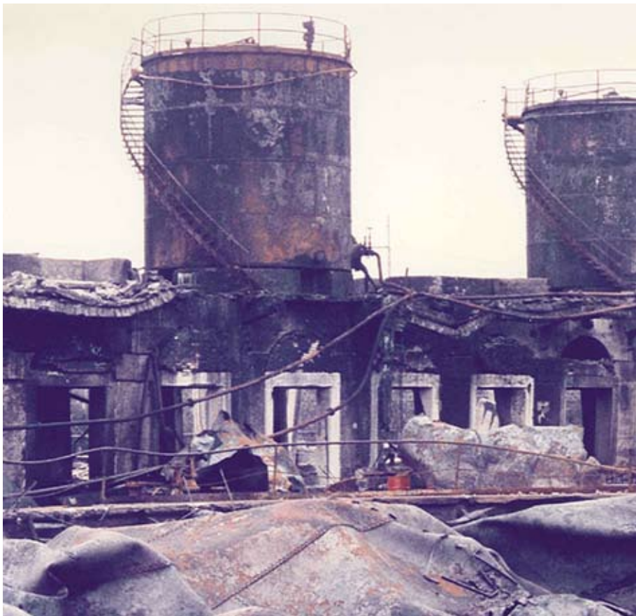
Figura 4.1.1 - Parte del deposito costiero Agip di Napoli dopo l'incidente del 1985
